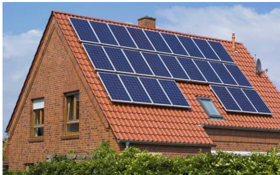
Figure 14: Solaire PV en alimentation dans un bâtiment
